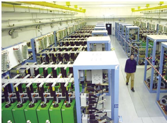
Kondensatorbank des Hochfeld-Magnetlabors im FZR (Fotos: FZR).
