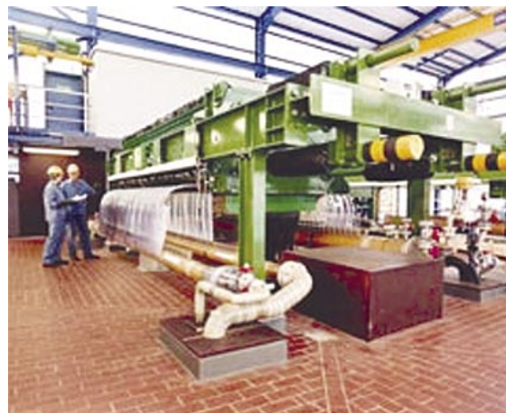
Salzsäure-Elektrolyseur mit der neuen Sauerstoffverzehrkatodentechnik am Standort Brunsbüttel (Foto: Bayer).
