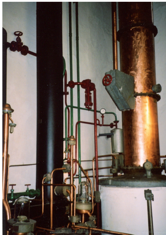
Abbildung 4: Ausschnitt aus der 7 m hohen Destillieranlage.
