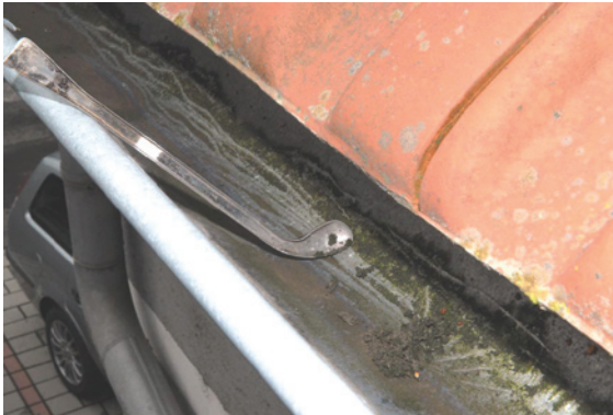
Abbildung 12: Bei sehr geringem Gefälle der Dachrinne bleibt mit der Zeit ein Teil des abgespülten Materials mehrerer Jahre in der Dachrinne liegen.
