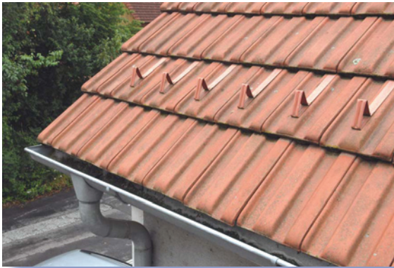
Abbildung 11: Eine große Dachfläche dient als „Target“ zum Aufsammeln von Staub aller Art, der vom Regen aus der Atmosphäre ausgewaschen wird.
