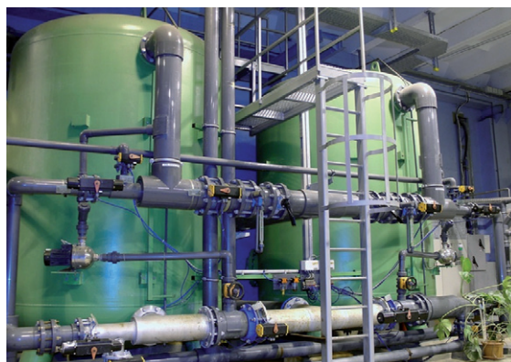
Abbildung 5: Betriebliches Lagertanks für Chemikalien.
