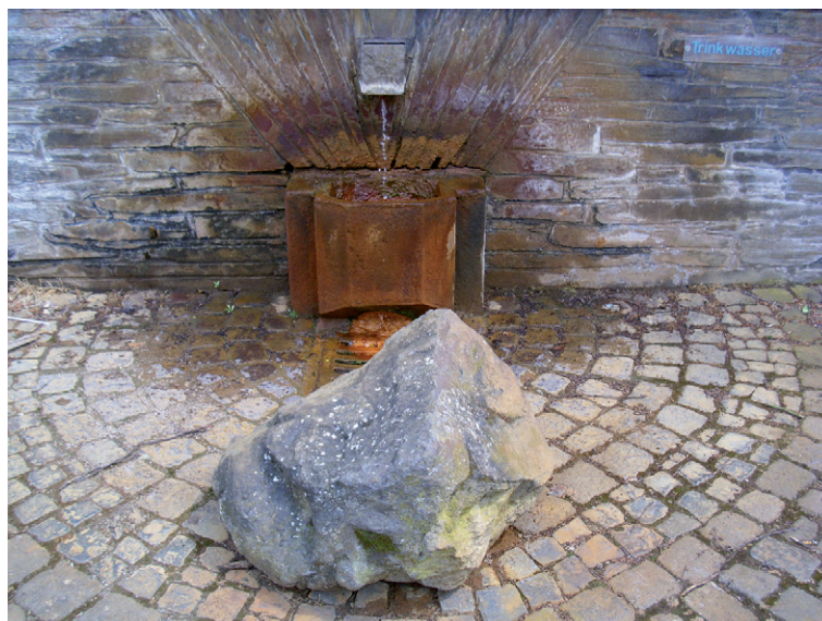
Sauerbrunnen Niederzissen mit Ablagerungen an Eisenocker.
